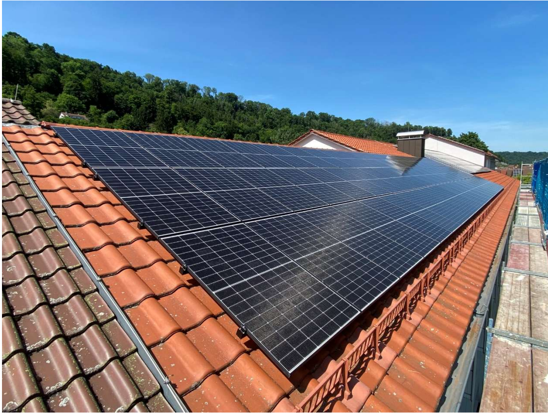
Foto 2: 66 PV-Module auf dem nach Süd-Osten orientierten Satteldach
